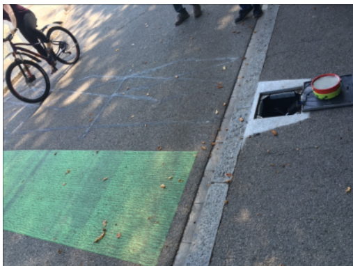
Point de comptage avec boîtier enterré à Dreibeinskreuzstrasse à Soleure
